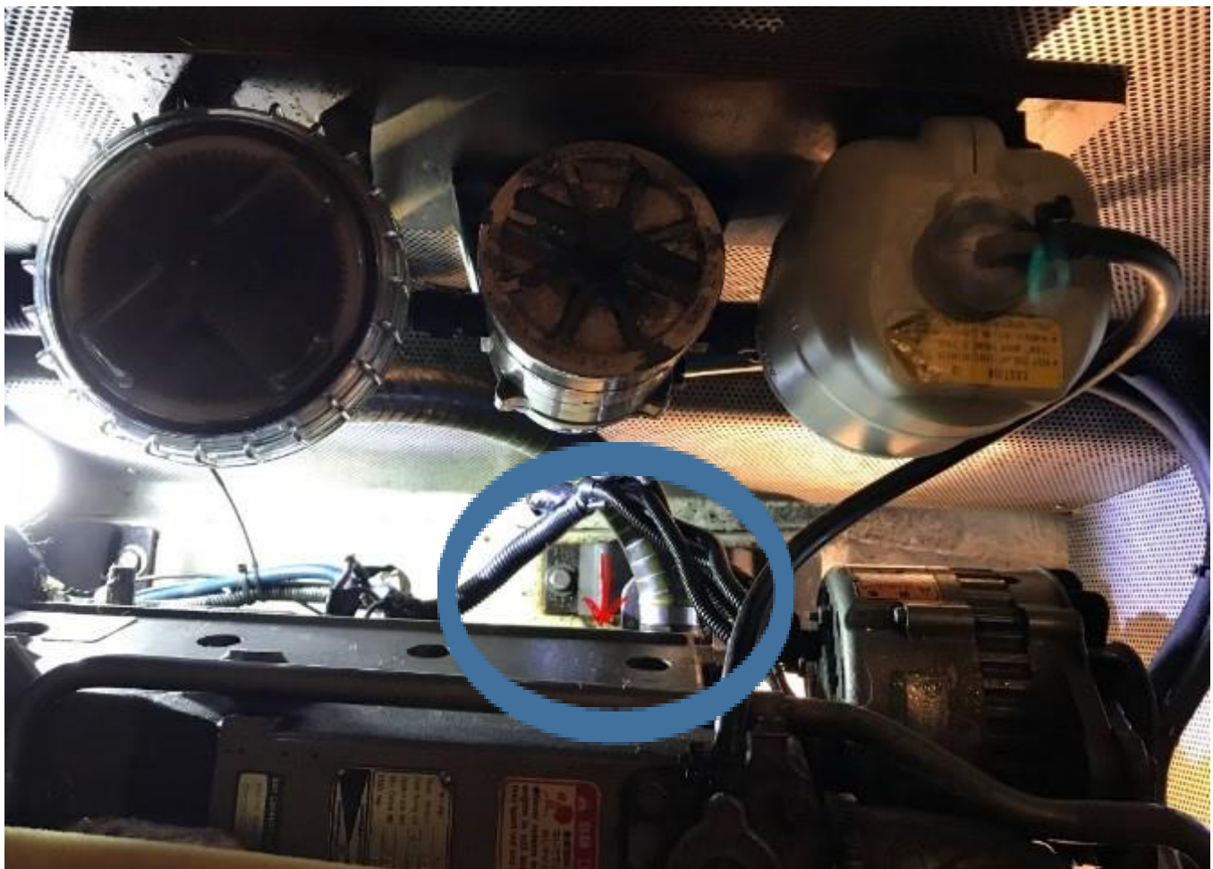
Figur 1 Set fra toppen og lodret ned af siden på motor med de 3 beholdere monteret på væggen. Søvandsfilter, Brændstoffiler og ekspansions beholder til kølevand
